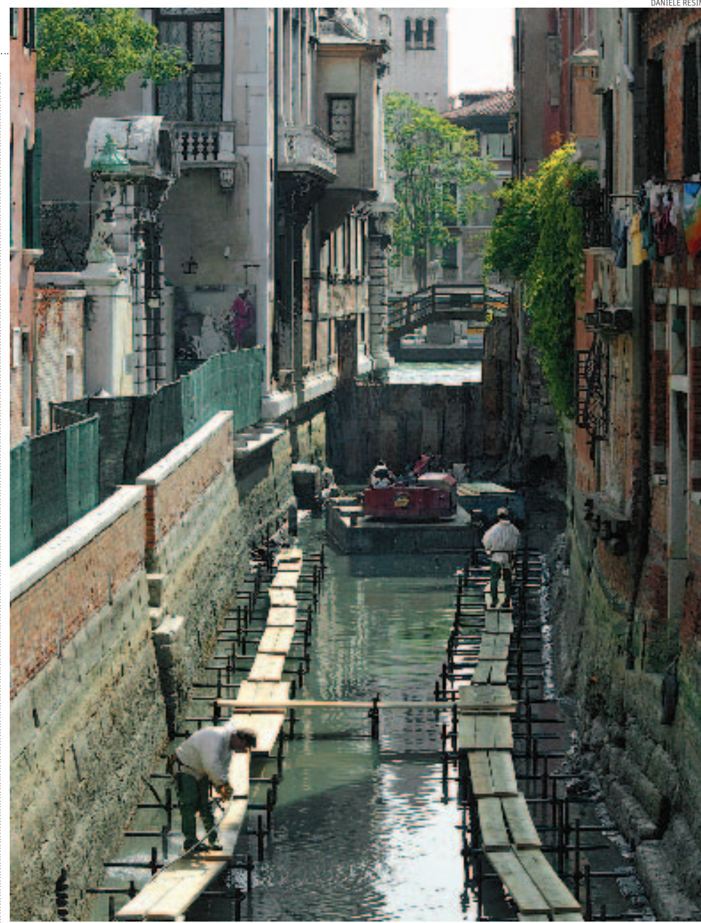
Venezia. L'immagine documenta l'intervento effettuato nel giugno 2003 lungo il Rio di San Barnaba
